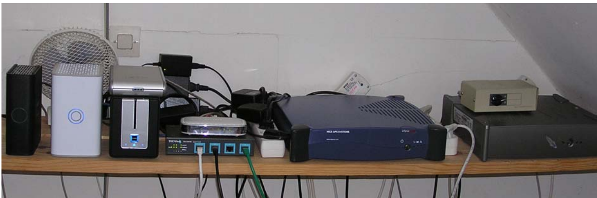
Onduleurs de secours, disques de sauvegarde et routage réseau
