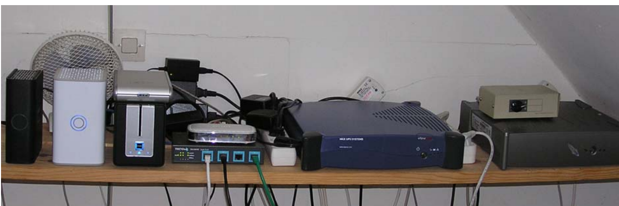
Wechselrichter (gegen Netzfehler), Backupplatten, Netzrouting
